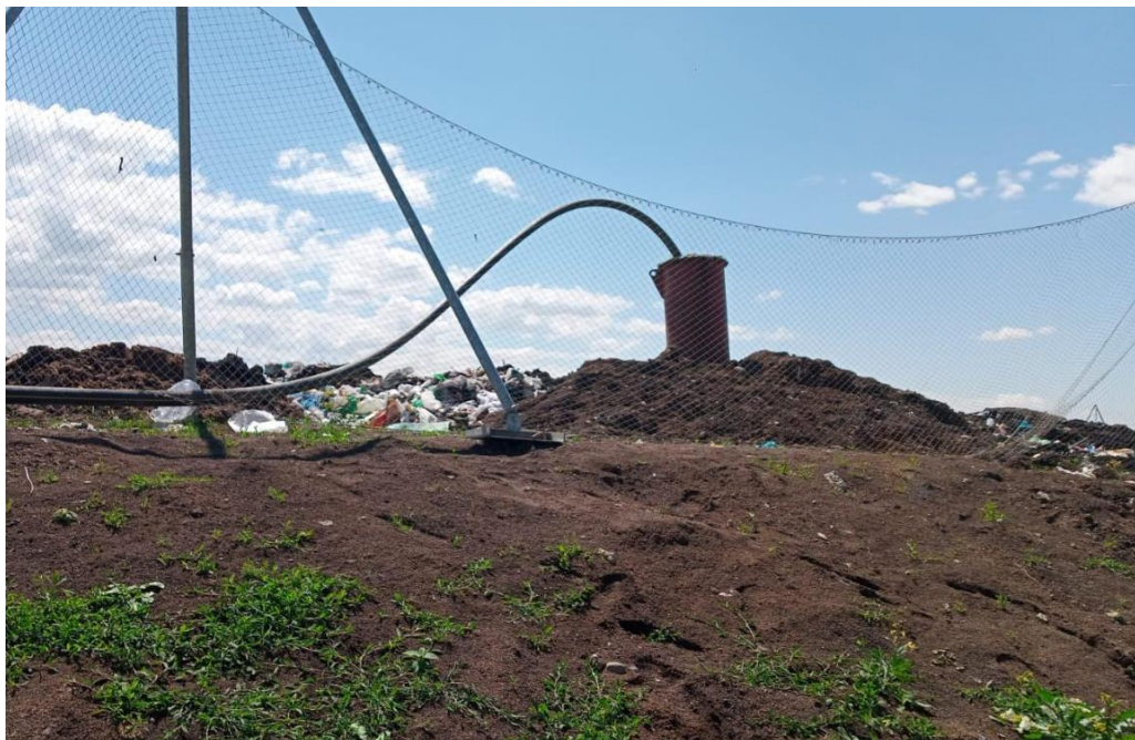
4 Puț pentru extracția gaz depozit
