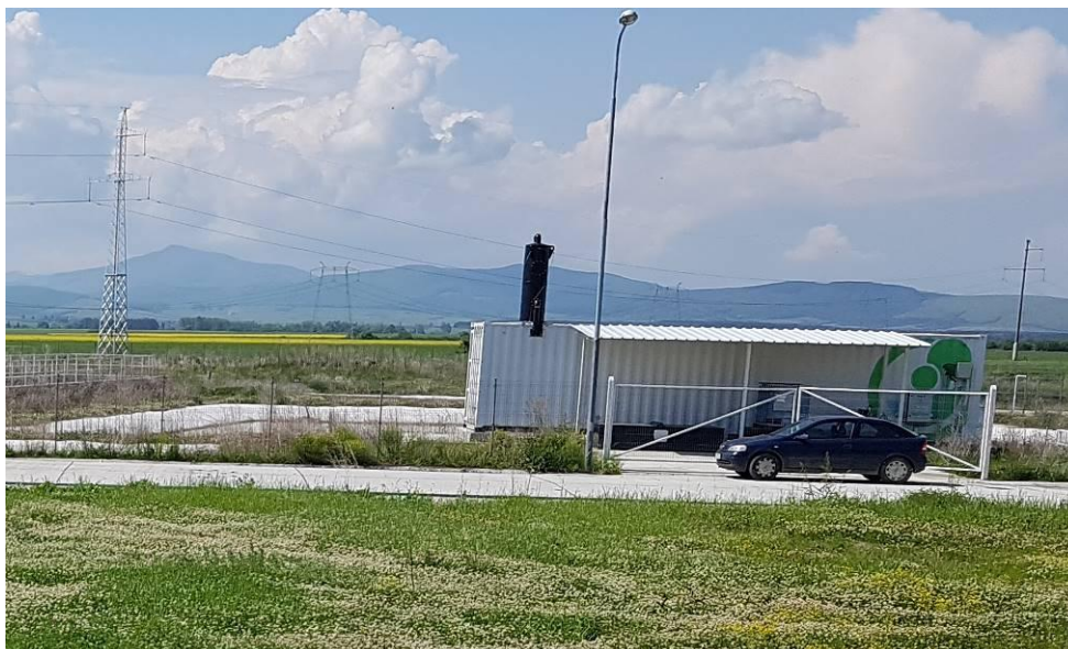
14. Stație epurare levigat
